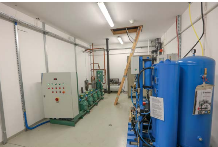
Rys. 2. Maszynownia, w której znajduje się aparatura chłodnicza oraz urządzenia do modyfikowania składu atmosfery w komorach
